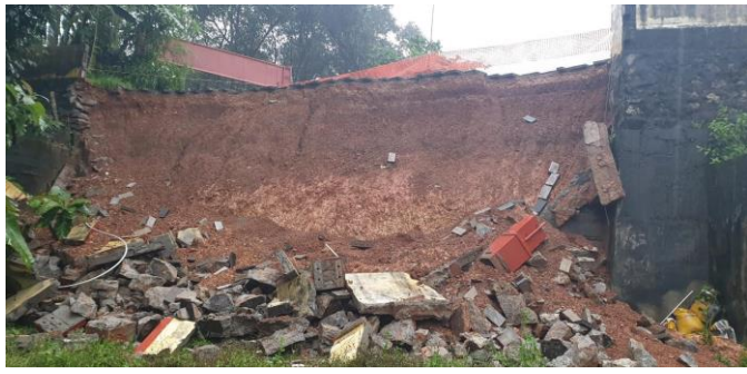
Die eingestürzte Stütz-Mauer...
